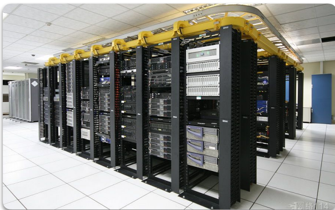
中心机房设备
